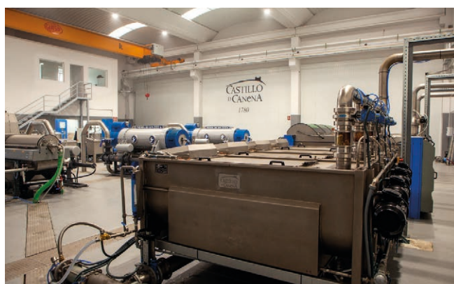
Esta almazara cuenta con tres líneas de molturación, dos Pieralisi SPI 222 y una de GEA CF3000.
