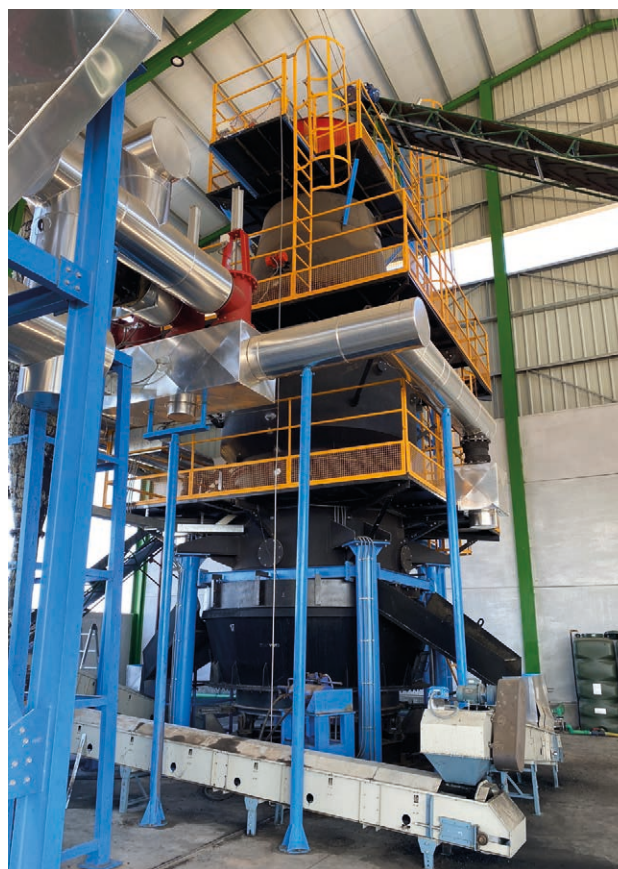
Vista del gasificador (tipo Downdraft o corrientes paralelas). Fuente BIOLIZA.
