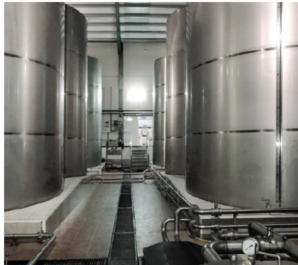
Depósitos de almacenamiento.
