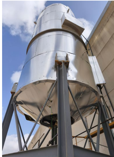
Digestor anaerobio de biogás para alperujo.
